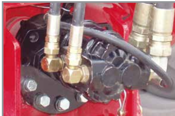
Установленный насос с приводом от ВОМ
